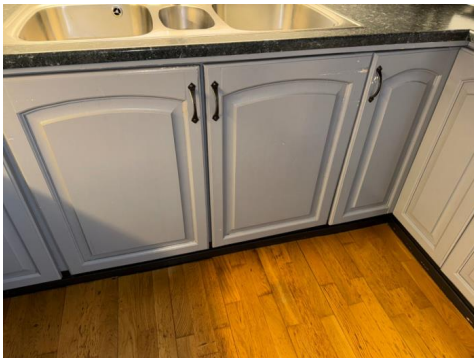
Slitasje på fronter og hengsler
