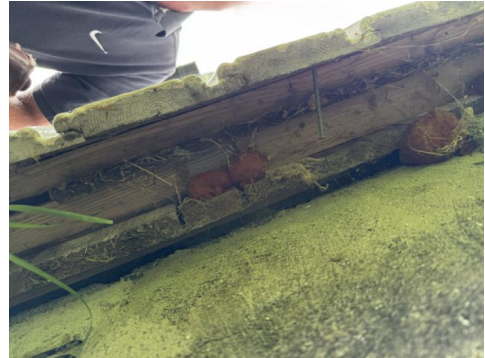
Ingen lufting bak kledning
