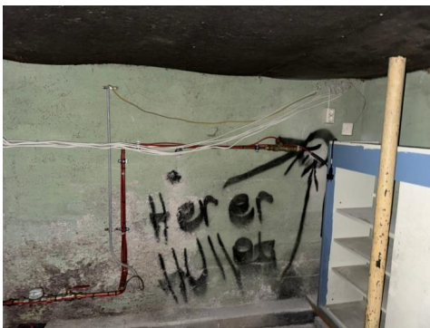
Løse/dårlig klamrede ledninger i kjeller.
