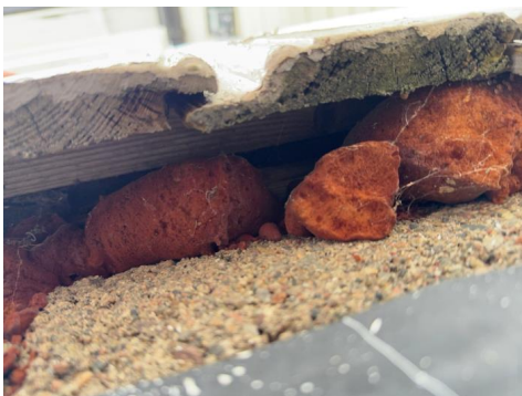
Ingen lufting bak kledning
