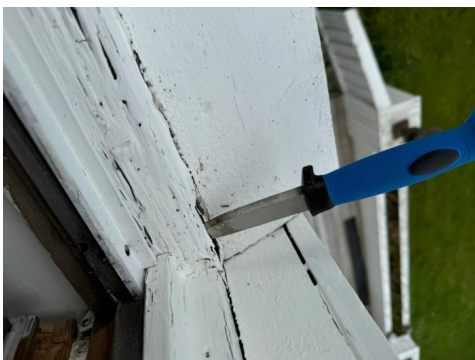
Vindu med råteskader
