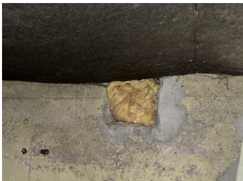
Lufteluker tettet med min.ull
