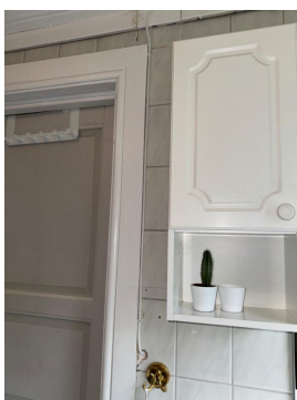
Dårlig klamrede ledninger bad.
