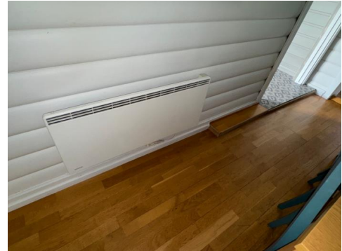
Panelovn på kjøkken
