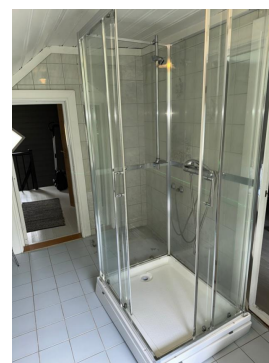
5mm fall fra toppslukrist til topp gulv ved dør til trapperom.
