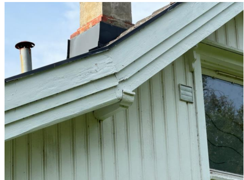
Råte i vindski og pyntekryss i gavlspiss
