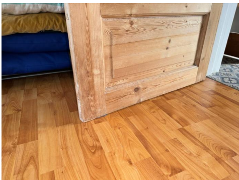
Dørblad tar i gulv.
