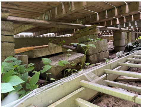
Terrasse med spinkel og skjev konstruksjon samt løse og skjeve i fundamenter.
