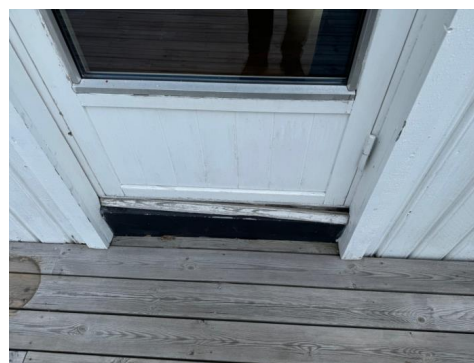
Mangelfullt beslag under terrassedør
