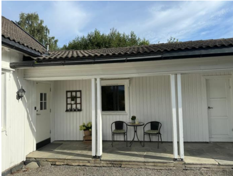
Manglende forkantbeslag i takrenne
