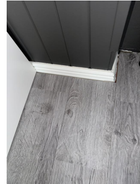
Manglende dekkplaster og nyere laminat på soverom
