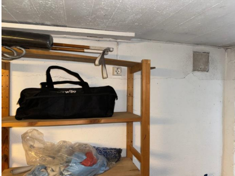
Horisontale riss i kjeller
