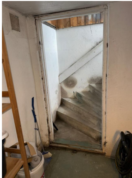
Innsiden av grunnmuren har misfarging
