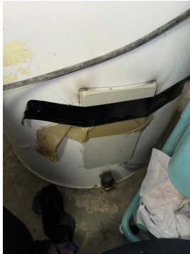
Svimerker på varmtvannsbereder
