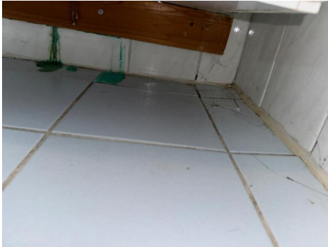
Sprekker og løse gulv/veggfliser.
