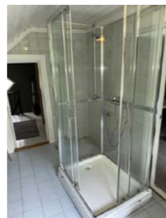
5mm fall fra toppslukrist til topp gulv ved dør til trapperom.
