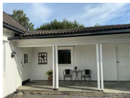
Manglende forkantbeslag i takrenne
