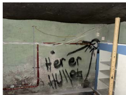
Løse/dårlig klamrede ledninger i kjeller.
