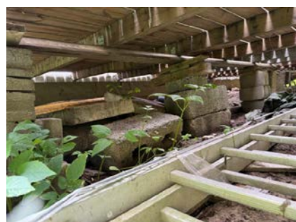
Terrasse med spinkel og skjev konstruksjon samt løse og skjeve i fundamenter.
