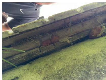
Ingen lufting bak kledning
