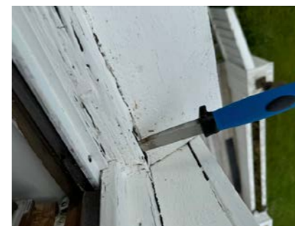
Vindu med råteskader
