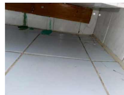
Sprekker og løse gulv/veggfliser.
