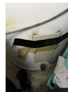
Svimerker på varmtvannsbereder
