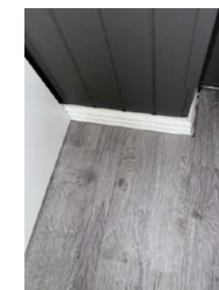
Manglende dekkplaster og nyere laminat på soverom
