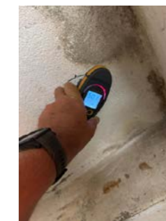
Fuktutslag flere steder langs gulv og kjellervegger
