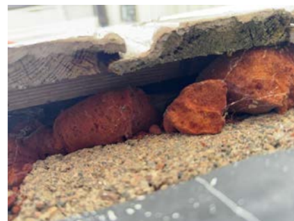
Ingen lufting bak kledning
