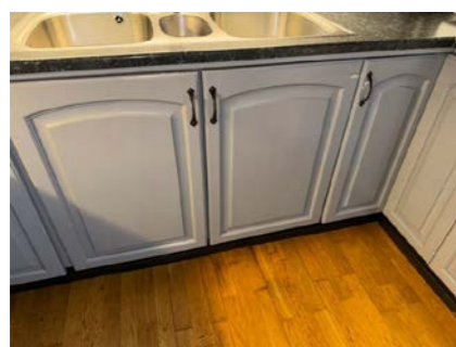
Slitasje på fronter og hengsler
