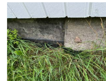
Klemlist på fuktsikring/grunnmursplast er stedvis manglende.
