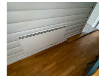
Panelovn på kjøkken
