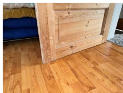
Dørblad tar i gulv.
