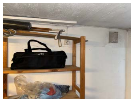
Horisontale riss i kjeller
