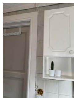
Dårlig klamrede ledninger bad.
