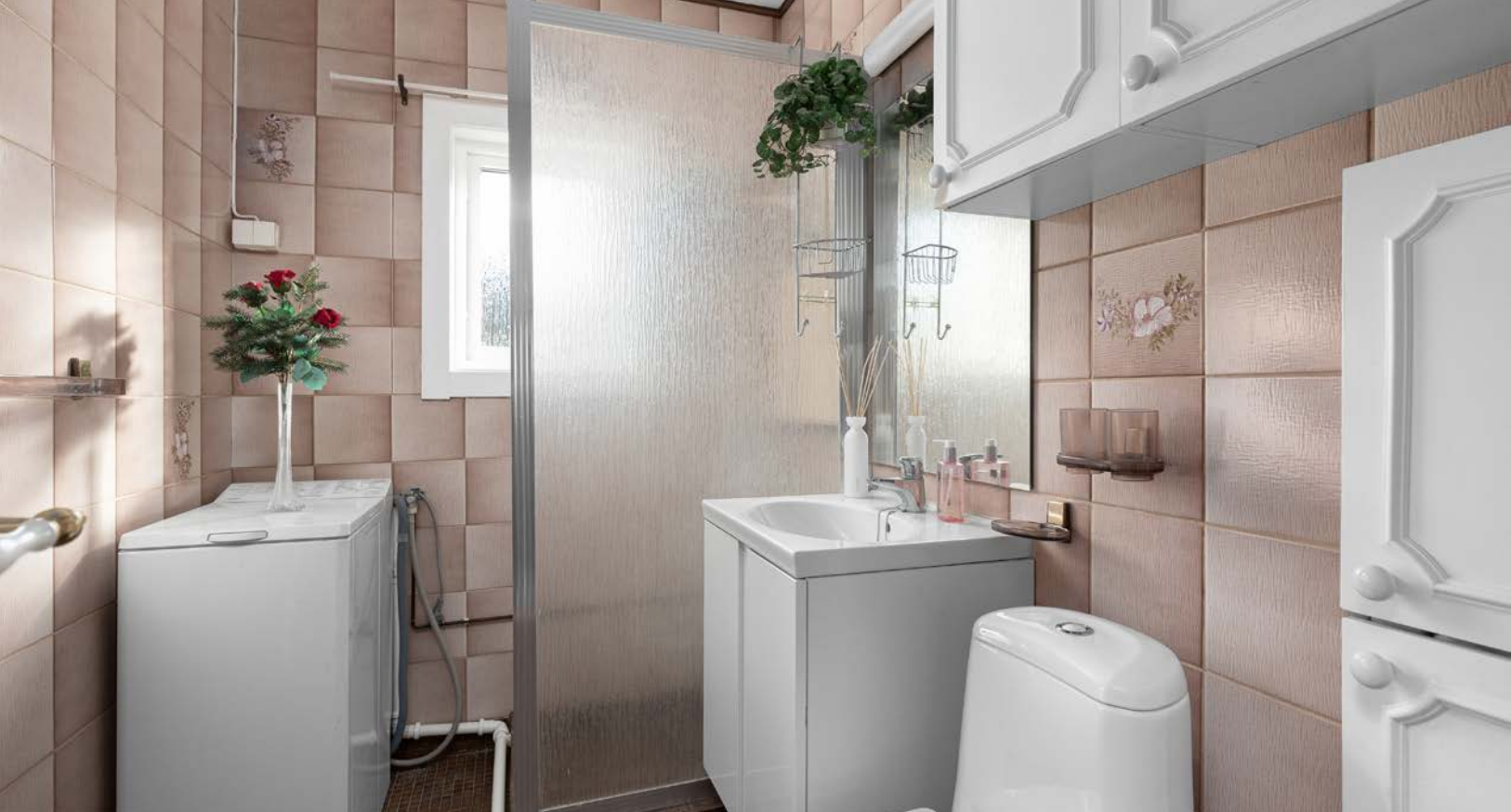
Romslig bad av eldre dato. Det behov for modernisering av bad.
