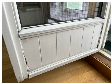
Råteskade på utsiden av panelet til døren.
