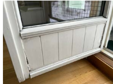
Råteskade på utsiden av panelet til døren.
