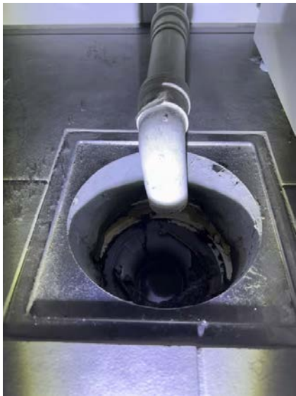
Sluk vaskerom er påsmurt.
