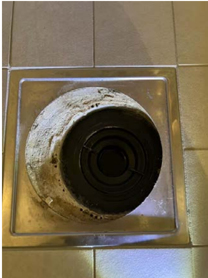
Membran er synlig ført under klemring.
