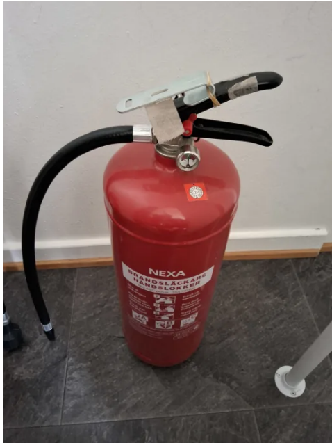
Brannslukningsapparat er plassert på soverom.
