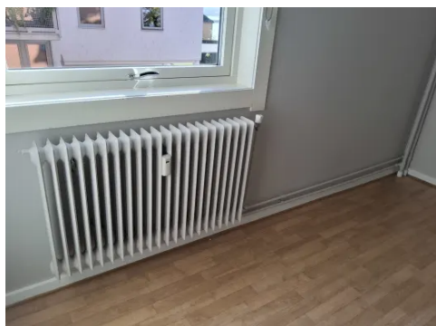
Deler av varmeanlegg er av eldre årgang.
