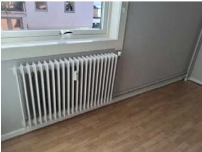
Deler av varmeanlegg er av eldre årgang.
