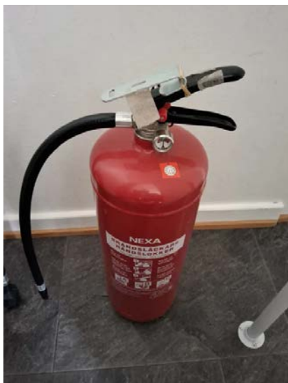
Brannslukningsapparat er plassert på soverom.
