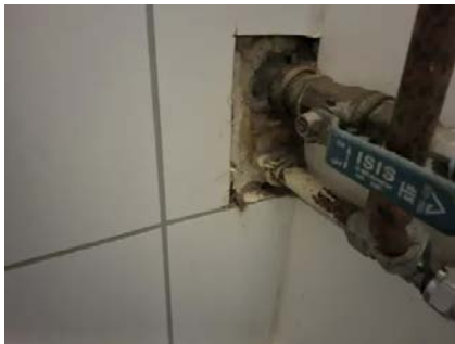
Rørgjennomføringer er tettet med fugemasse.
