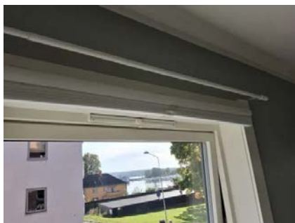
Naturlig ventilasjon med blant annet spalteventiler i vinduer.
