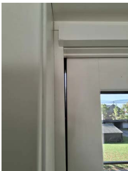
Bilde viser gløpe mellom dørblad og karm i lukket posisjon.
