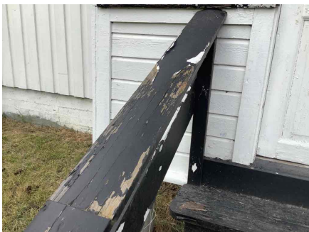
Slitasje på trapp til vinterhage.
