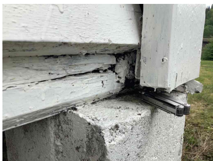
Råte i gulvbjelke på vinterhage.
