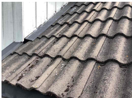
Falming av overflater og stedvis mosevekst.
