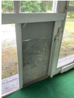
Et glass er knust og erstattet med tett plate på innglasset terrasse.
