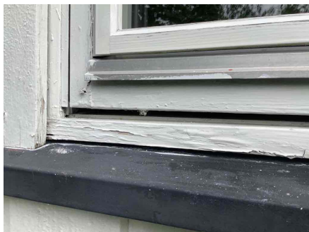
Eksempel på slitasje på vindu.
