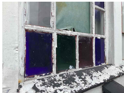
Kraftig slitasje på vinduer i vinterhage.
