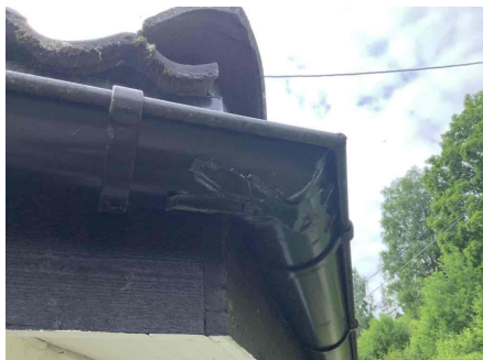
Lekasje fra skjøt på takrenne ved entre.
