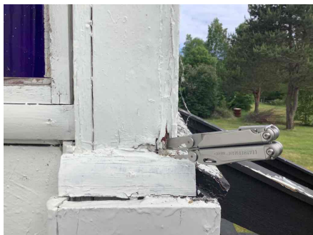
Råte i kledning rundt søyle på vinterhage.
