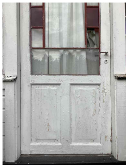
Kraftig slitasje på dør til vinterhage.
