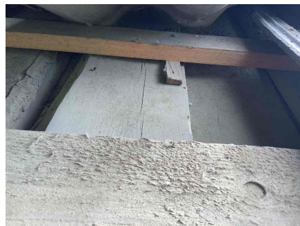
Det er ikke tett undertak under taksteinen.
