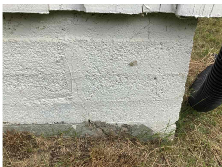
Sprekk i grunnmur på hjørne mot hage.
