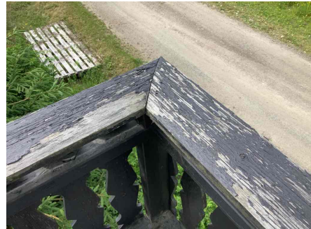
Slitasje på toppbord på balkong.
