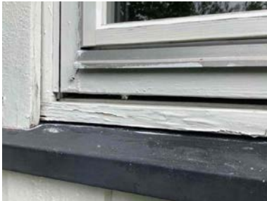
Eksempel på slitasje på vindu.
