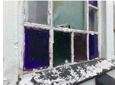
Kraftig slitasje på vinduer i vinterhage.
