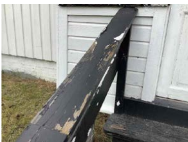
Slitasje på trapp til vinterhage.
