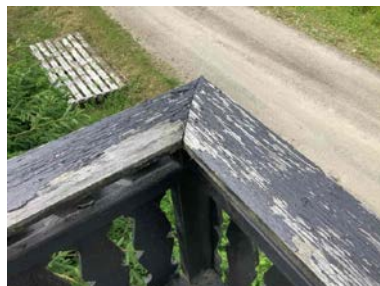
Slitasje på toppbord på balkong.
