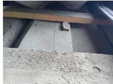
Det er ikke tett undertak under taksteinen.
