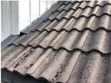
Falming av overflater og stedvis mosevekst.
