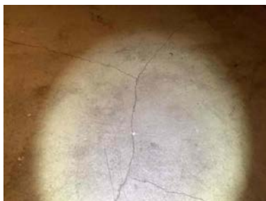
Eksempel på sprekker i gulv.
