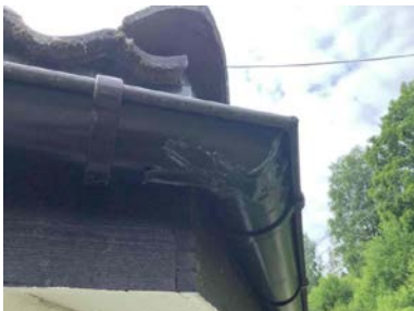
Lekasje fra skjøt på takrenne ved entre.
