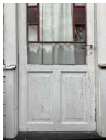
Kraftig slitasje på dør til vinterhage.
