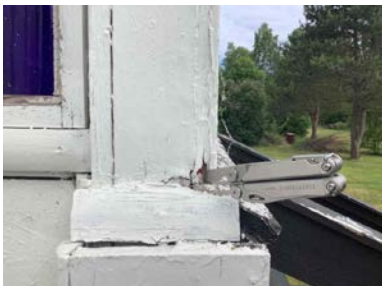
Råte i kledning rundt søyle på vinterhage.
