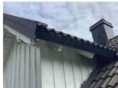
Det er ikke forkantbeslag på takfot på takutbygg i 2. etasje.
