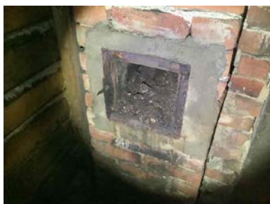
Det er ikke dør på sotluke i kjeller.
