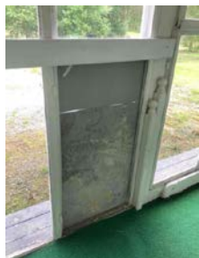
Et glass er knust og erstattet med tett plate på innglasset terrasse.
