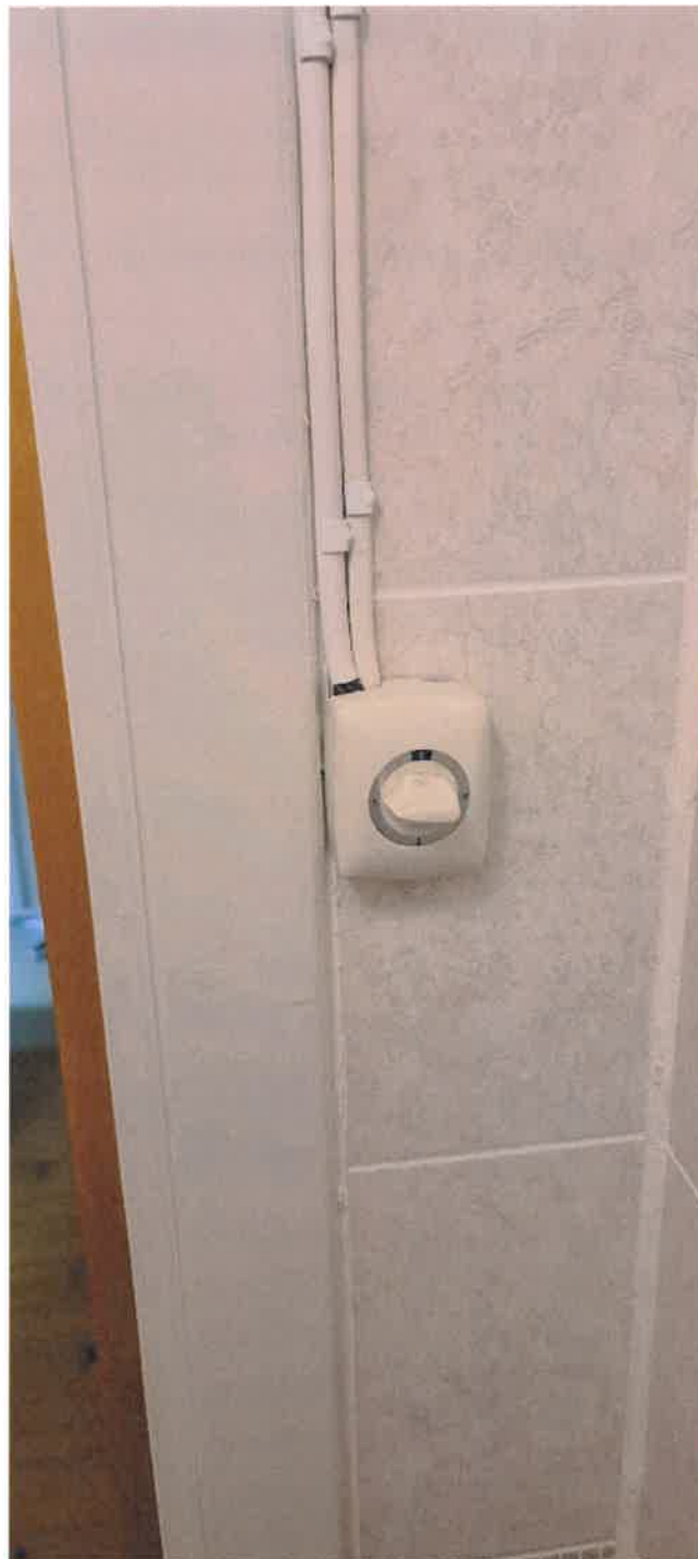
Ytterkabel på el.ledning inn i bryter er avsluttet før bryter.
