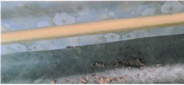
Oppsmuldring/råte i bunn baderomsplater med vannrør montert uten på plater.
