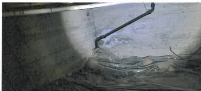
Bilde viser kalkutslag i ytterhørner på betongvegger samt ujevnheter under plast. Sporskåler bør fjernes på vannrør; uheldig i forbindelse med brann; avgir gass..
