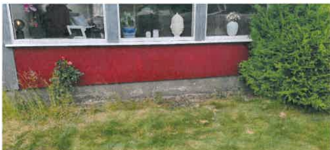
Eternitplater under vinduer i stue.
