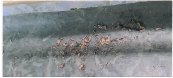
Rester fra bunn baderomspånal på gulv.
