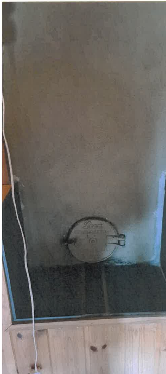
Feieluke hvor det er montert flis under og på siden av feieluke.
