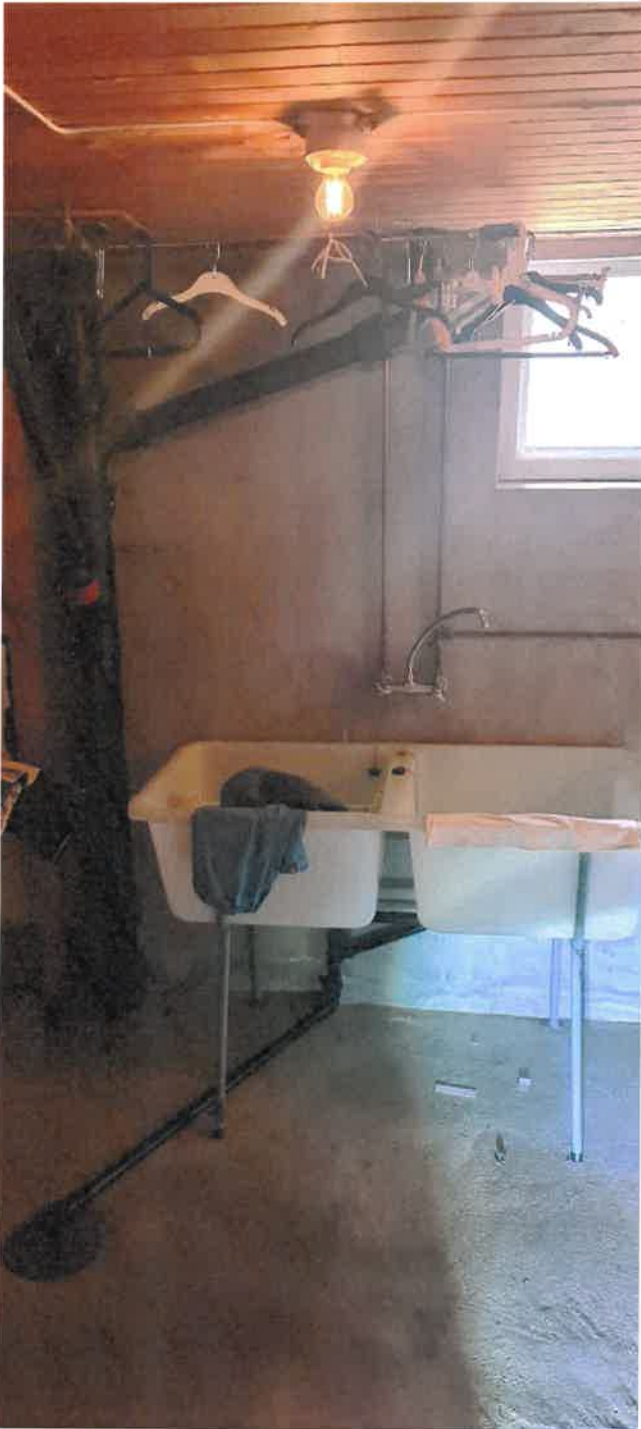
Bilde viser plasstskyllekar på stativ, merker etter fuktighet på vegg under skyllekar.
