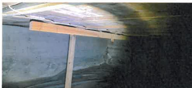
Bilde viser kalkutslag i ytterhørner på betongvegger samt drager med understøttelse for å stabilisere bjelkelag i stue.
