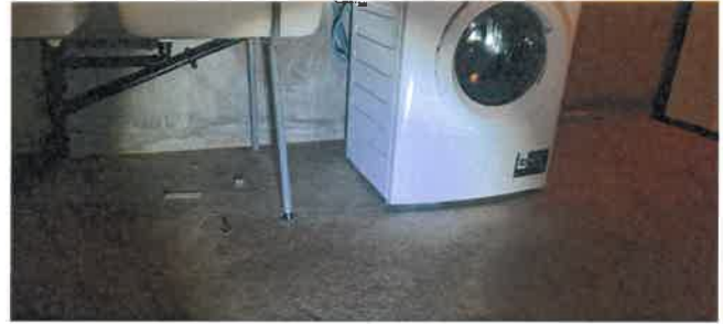
Bilde viser plasstskyllekar på stativ, merker etter fuktighet på vegg ved vaskemaski.
