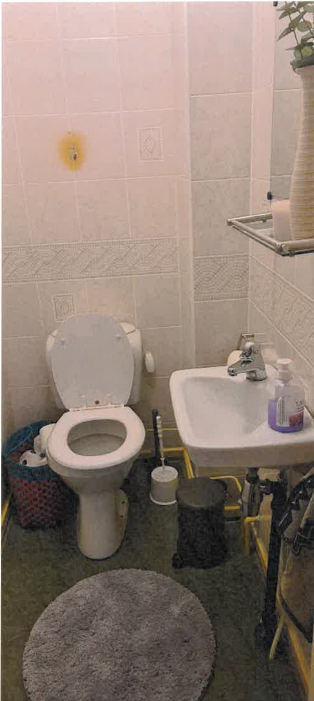
Servant på høyre side og toalett bak, hvor skade på vegg vises over toalett.
