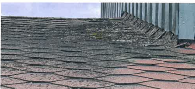
Mye mose og skader i overflate på Shingel.
