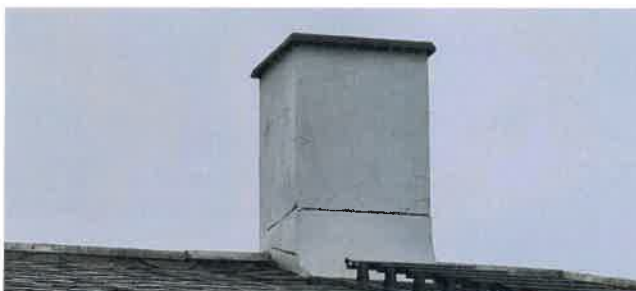
Pusset og malt pipe, hvor det er riss/sprekker i pussoverflate med bunnbeslag.
