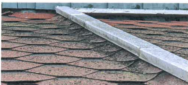
Bilde viser mye mose i overflate samt list i overgang vegg/teking.
