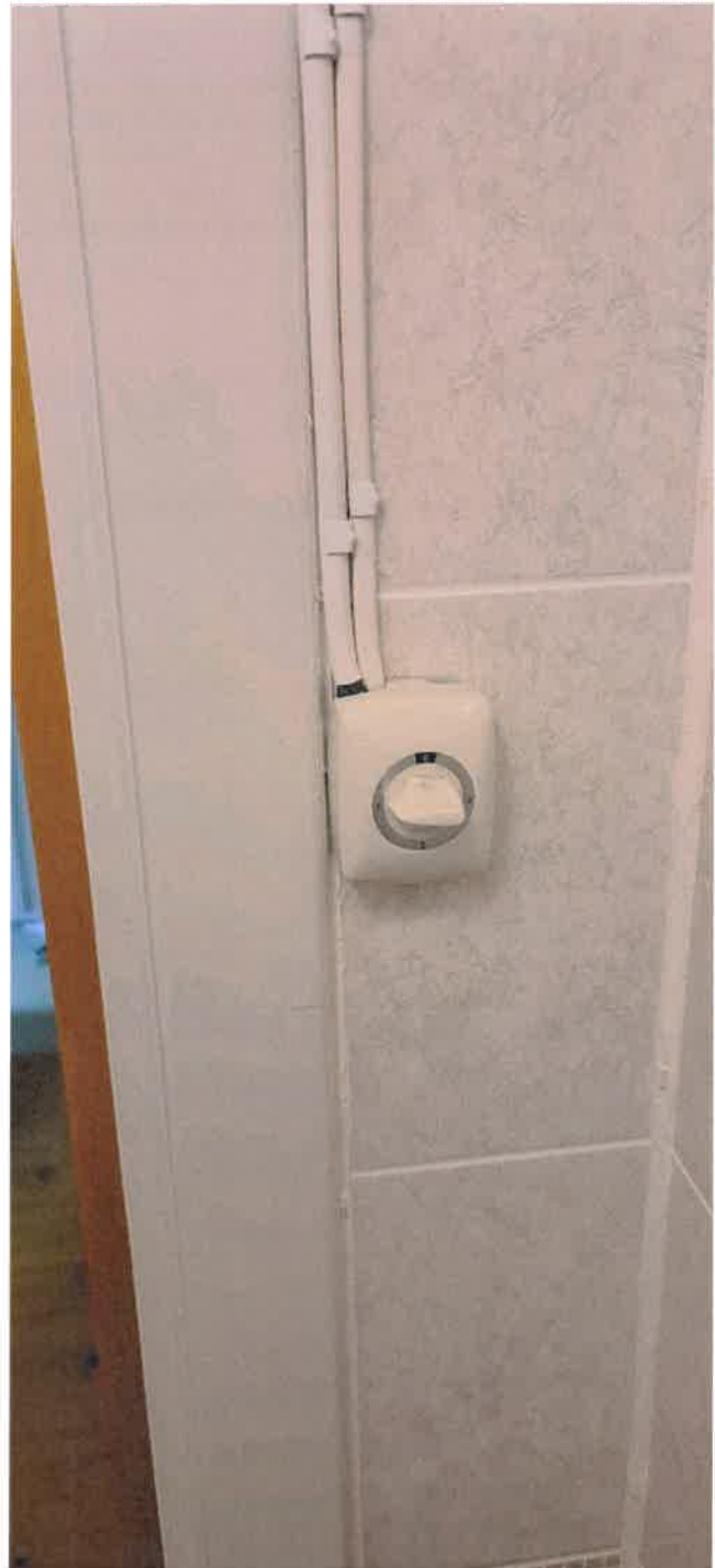
Bryter ved dør hvor kabbe på el ledning er avsluttet utenfor bryter.
