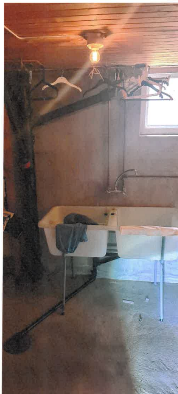
Bilde viser plasstskyllekar på stativ, merker etter fuktighet på vegg under skyllekar.
