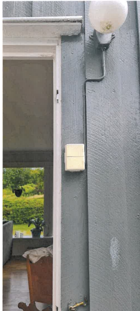
Stikkontakt ved terrassedør er feil montert; den drenerer ikke ut eventuelt fuktighet.
