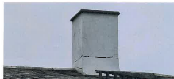
Pusset og malt pipe, hvor det er riss/sprekker i pussoverflate med bunnbeslag.
