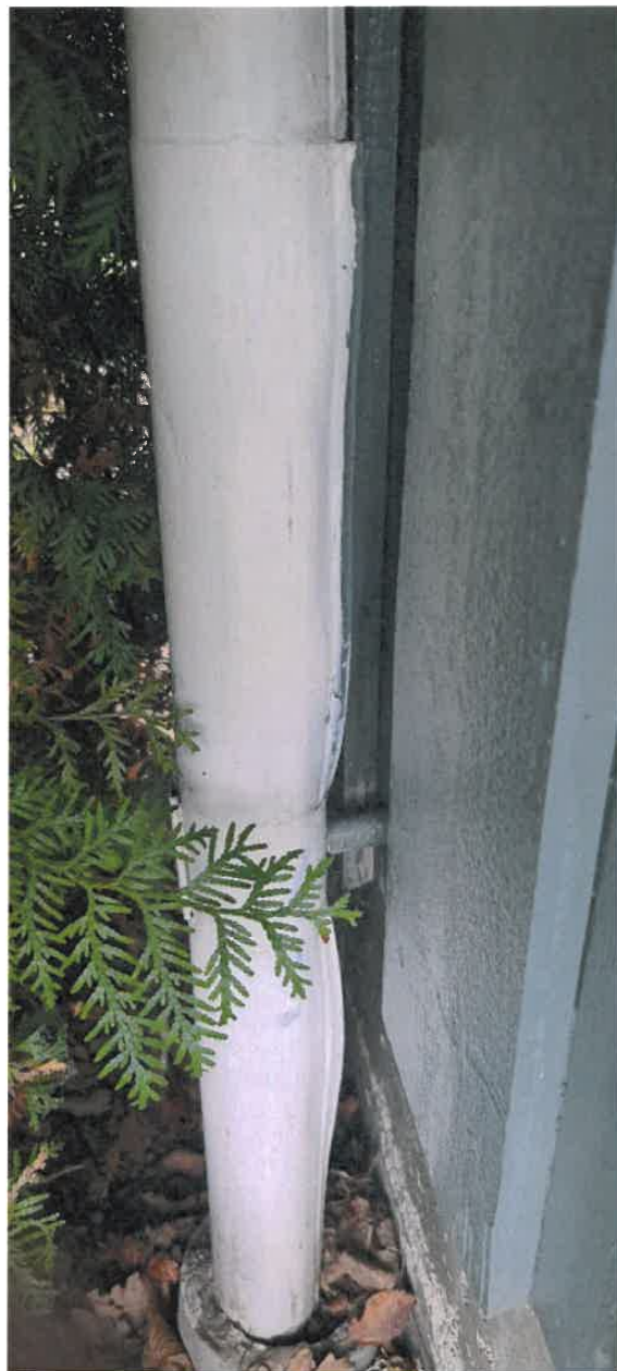
Nedløp som er sprukket på vegg mot kommunal veg.
