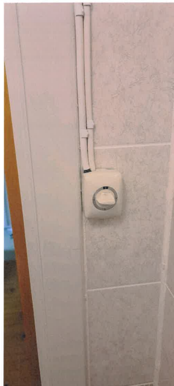
Bryter ved dør hvor kabbe på el ledning er avsluttet utenfor bryter.
