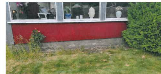
Eternittplater under vinduer i stue.
