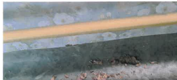
Oppsmuldring/råte i bunn badromsplater med vannrør montert utenpå plater.
