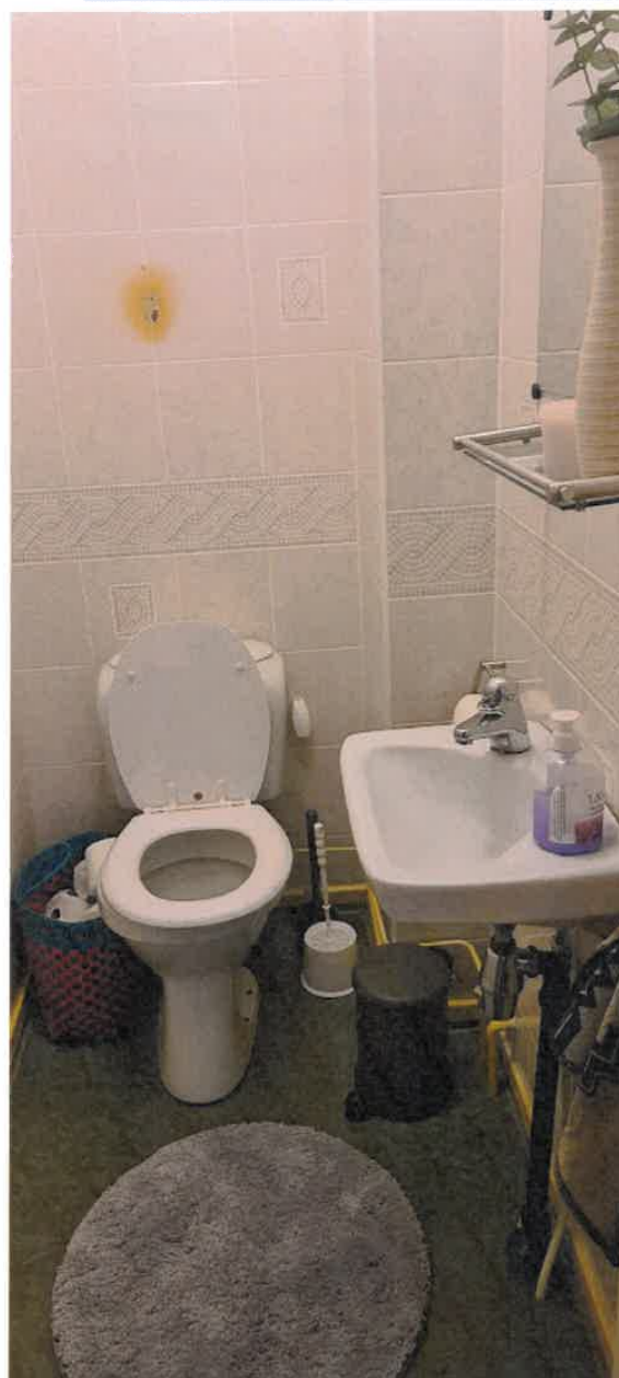
Servant på høyre side og toalett bak, hvor skade på vegg vises over toalett.
