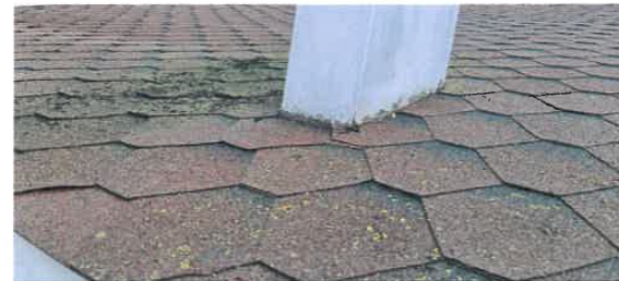
Løsning med Shingel rundt ventilasjonskanal kan være utsatt for fukt gjennomslag
