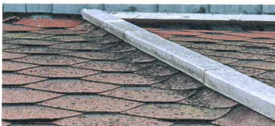
Bilde viser mye mose i overflate samt list i overgang vegg/tekking.
