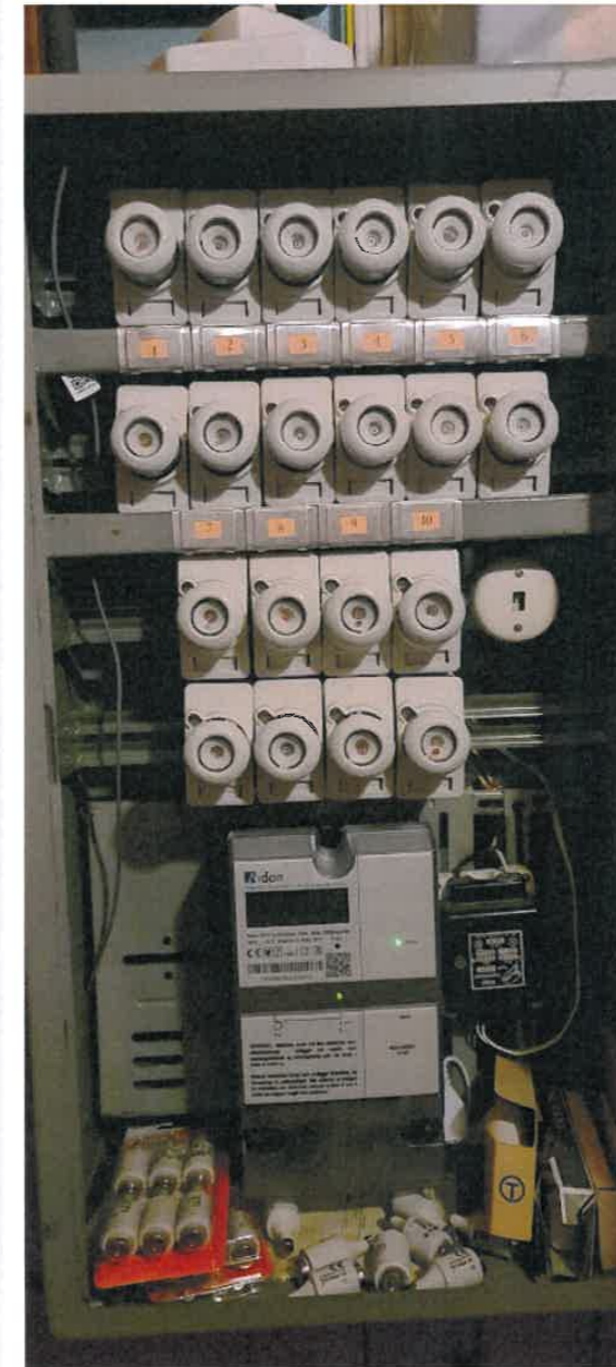
Skrusikringer i sikringskap.
