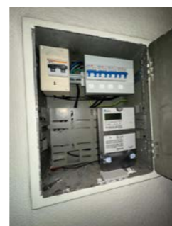
Sikringsskap med automatsikringer.
