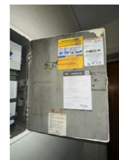
Manglende kursoversikt i sikringsskap
