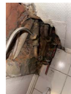
Stoppekraner plassert bak kasse på wc.
