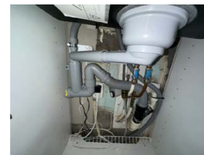
Rørøpplagg i kjøkkenbenk med Waterguard
