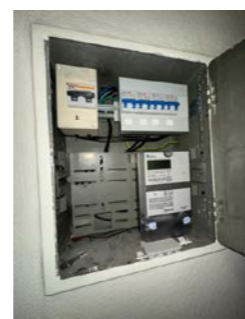
Sikringsskap med automatsikringer.
