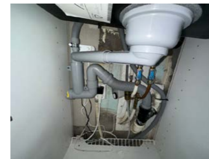
Rørøpplagg i kjøkkenbenk med Waterguard
