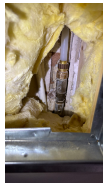
Stoppevrider i inspeksjonsluke i soverom.
