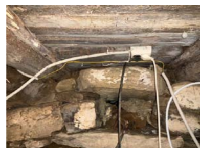
El-arbeid i kjeller fremstår med ufagmessig utførelse.
