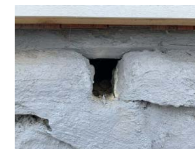
Hull i grunnmur, mulig for skadedyr/mus å komme inn.
