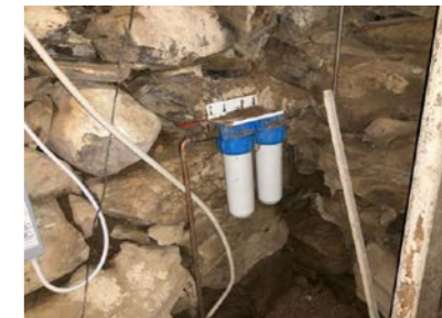
Hovedstoppekran montert ved filter.
