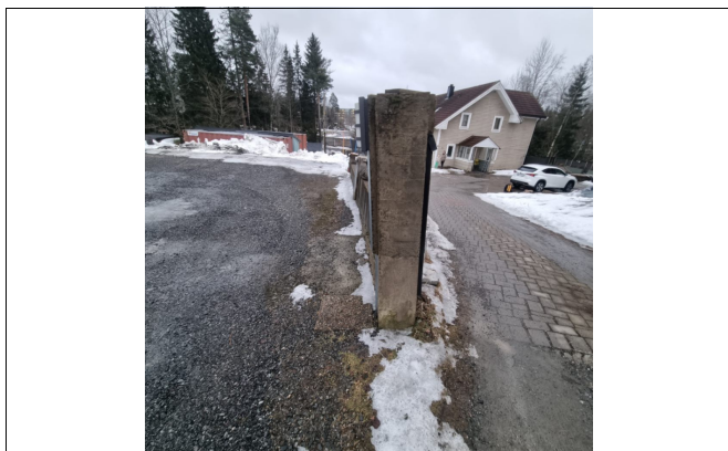
Skjev mur ved innkjøring.
