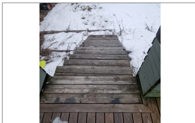
Slitt og underdimensjonerte trappetrinn. Mangler rekkverk.
