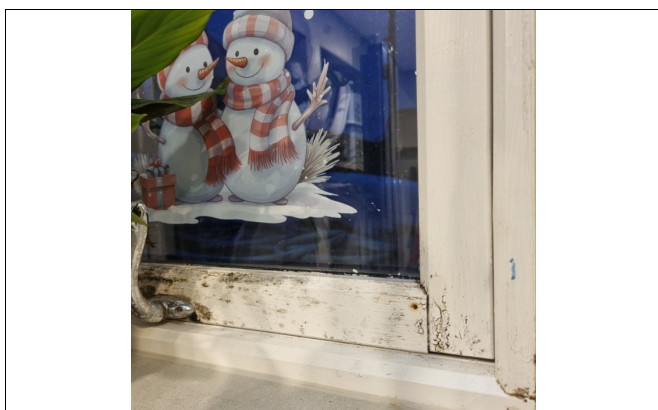
Manglende vedlikehold på vindu.
