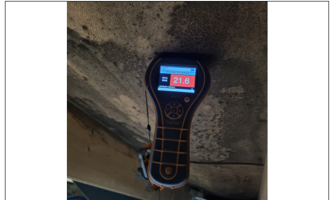
Høy luftfuktighet og stor muggdannelser i undertaket.
