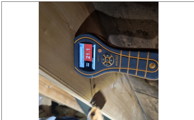
Høy luftfuktighet i bjelker samt stor muggdannelser i undertaket.
