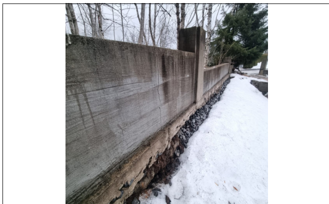
Sprekk/ skadet forstøtningsmur.
