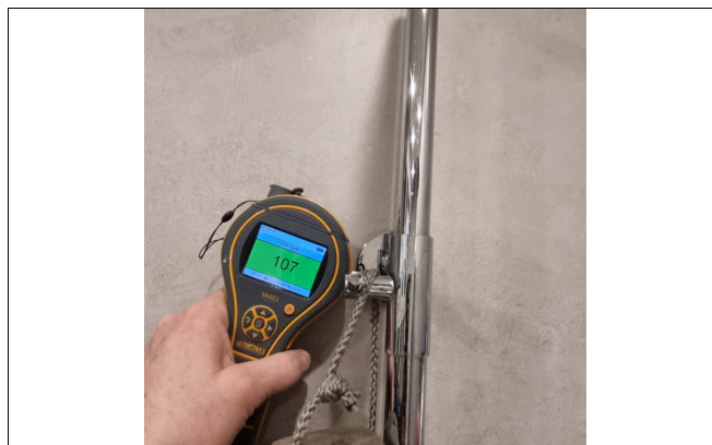
Kontrolløk med fuktmåler i dusjsjonen.
