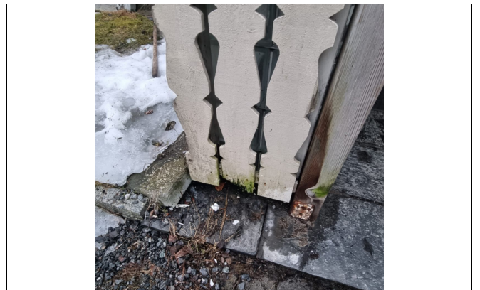
Råteskade på panelbord.
