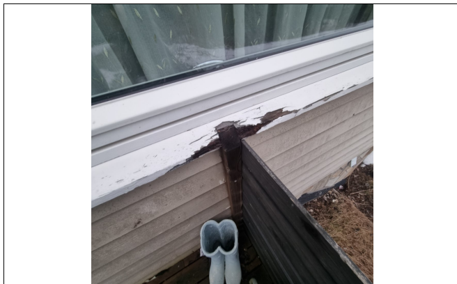
Råteskade på vannbrett.
