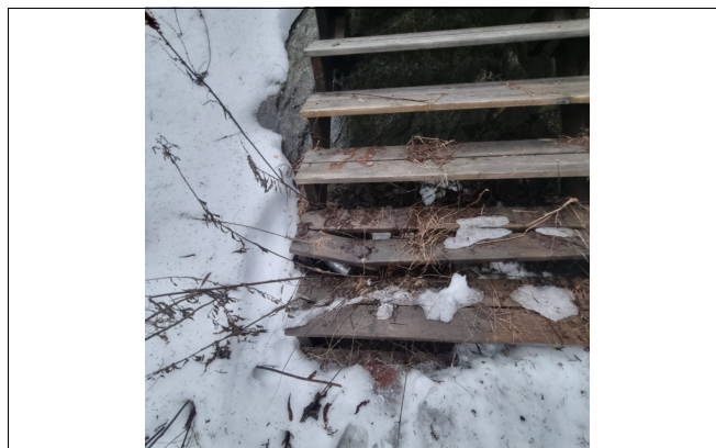
Skader på trappetrinn utvendig trapp.
