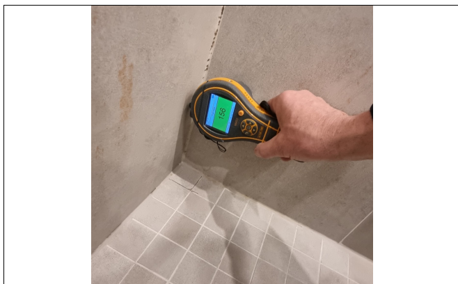
Kontrolløk med fuktmåler i dusjsjonen.
