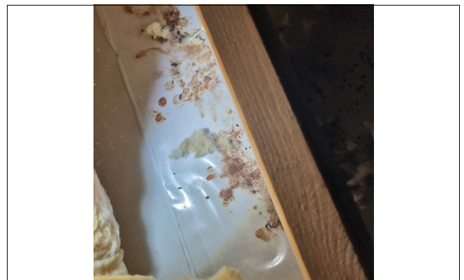
Registrert avføring etter mus under isolasjon på kald loft.
