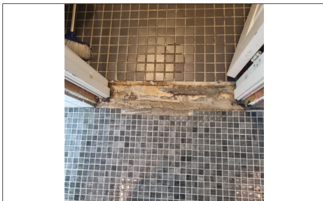
Bad 2.etasje. Ikke tilfredsstillende membranløsning i gulv.
