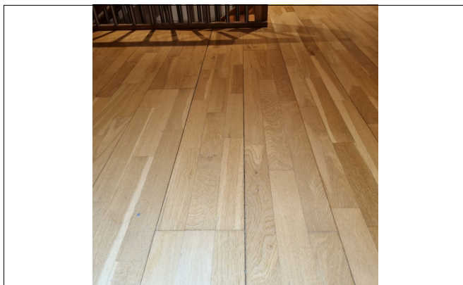
Ujevn parkett på gulv i 2.etasje.
