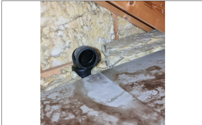
Soilrør er avsluttet inne på kald loft. Varmluft inne på kald loft har ført til store høy luftfuktighet og stor muggdannelser i undertaket.
