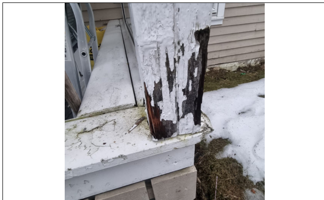
Råteskade på stolpe på inngangspartiet.
