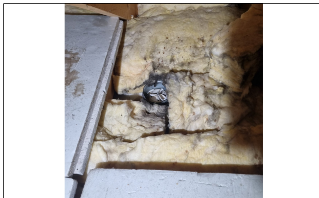
Avtrekk fra ventil på kald loft er ikke ført over tak.
