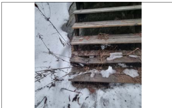
Skader på trappetrinn utvendig trapp.
