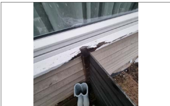
Råteskade på vannbrett.
