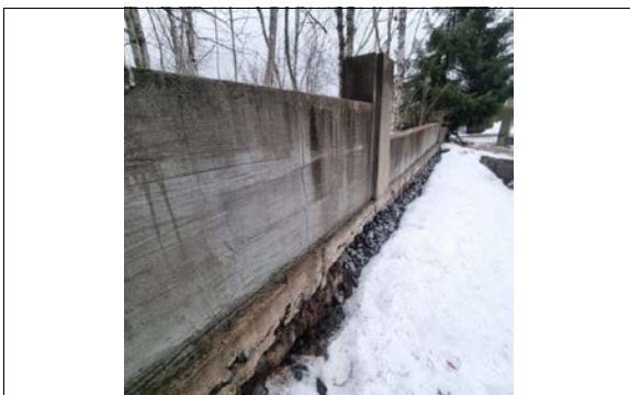
Sprekk/ skadet forstøtningsmur.
