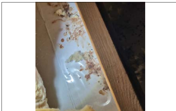
Registrert avføring etter mus under isolasjon på kald loft.
