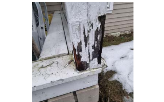
Råteskade på stolpe på inngangspartiet.
