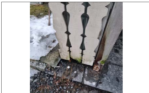
Råteskade på panelbord.
