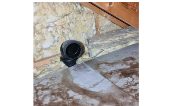
Soilrør er avsluttet inne på kald loft. Varmluft inne på kald loft har ført til store høy luftfuktighet og stor muggdannelser i undertaket.
