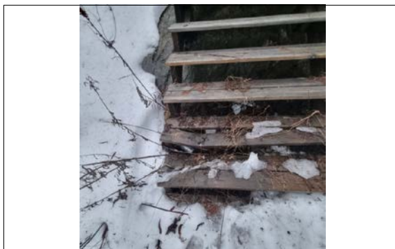
Skader på trappetrinn utvendig trapp.
