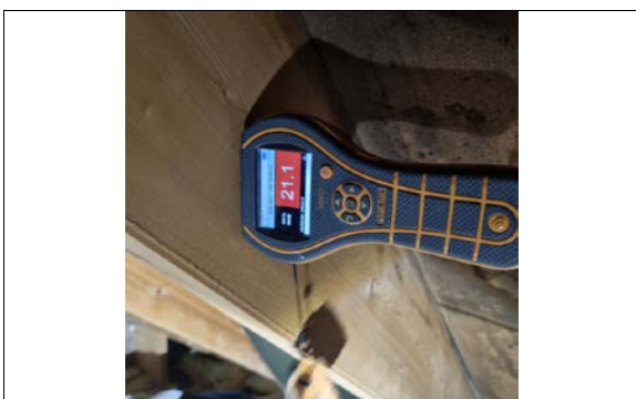
Høy luftfuktighet i bjelker samt stor muggdannelser i undertaket.
