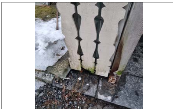
Råteskade på panelbord.
