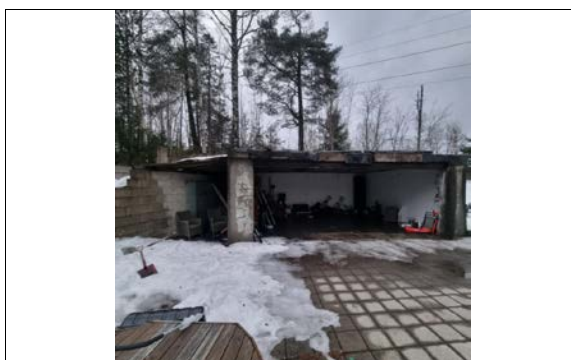
Garasje er i dårlig tilstand. Lekkasje i tak og vegg.
