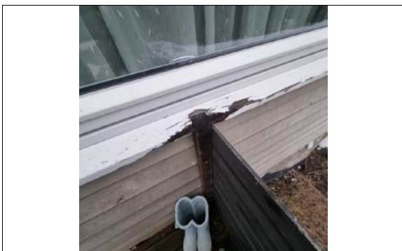
Råteskade på vannbrett.
