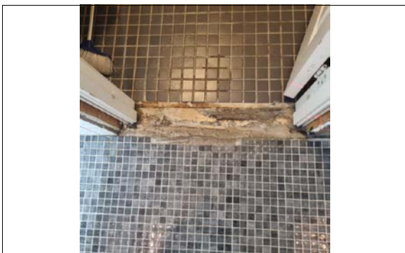
Bad 2.etasje. Ikke tilfredsstillende membranløsning i gulv.
