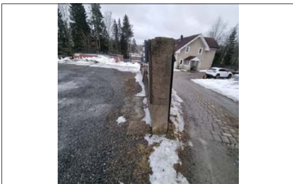
Skjev mur ved innkjøring.
