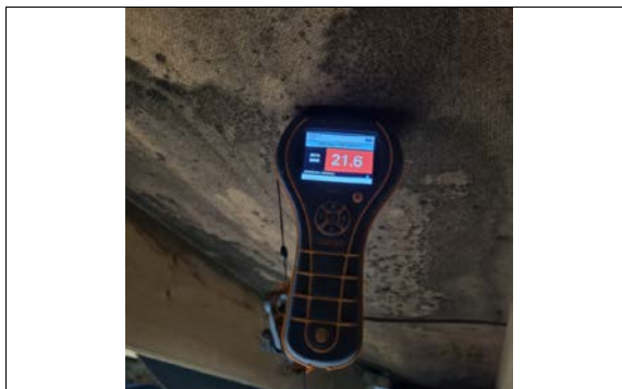
Høy luftfuktighet og stor muggdannelser i undertaket.
