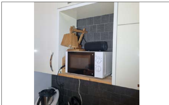
Mangler ventilator på kjøkken til utleiedel.
