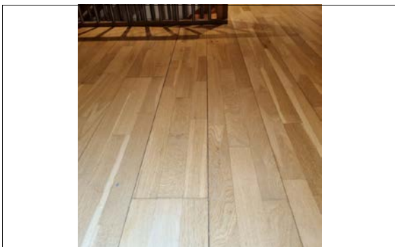
Ujevn parkett på gulv i 2.etasje.
