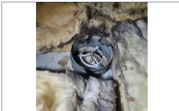
Avtrekk fra ventil på kald loft er ikke ført over tak.
