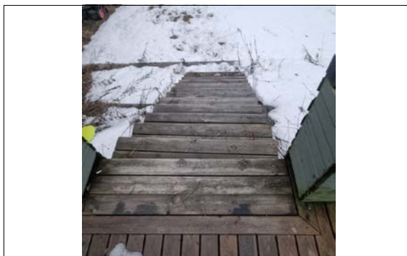
Slitt og underdimensjonerte trappetrinn. Mangler rekkverk.
