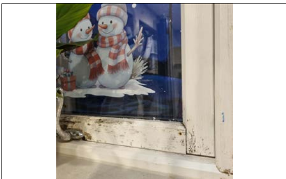
Manglende vedlikehold på vindu.
