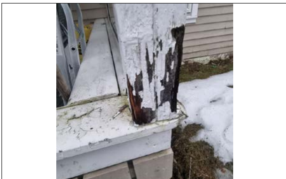
Råteskade på stolpe på inngangspartiet.
