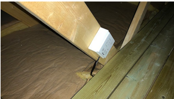
Styring til ventilasjon
