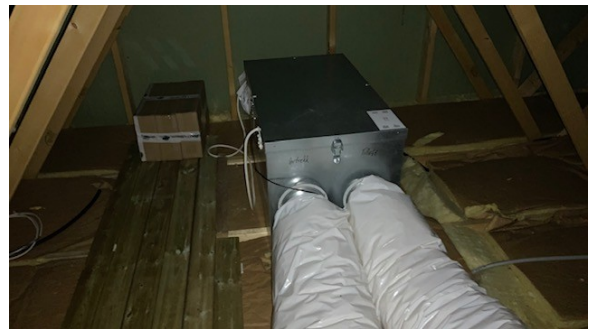
Ventilasjonsanlegg på loft
