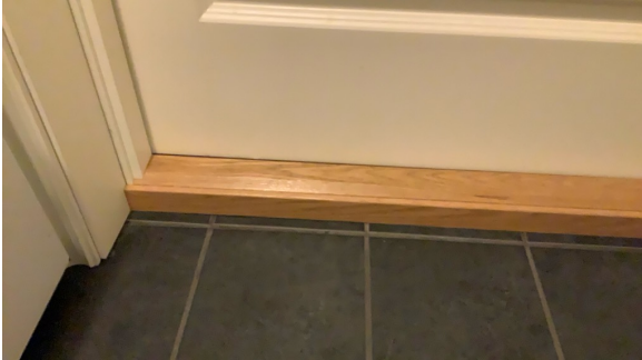
Ingen spalte ved dør
