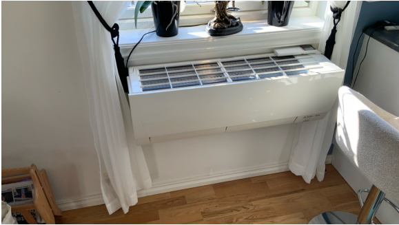
Varmepumpe i stue
