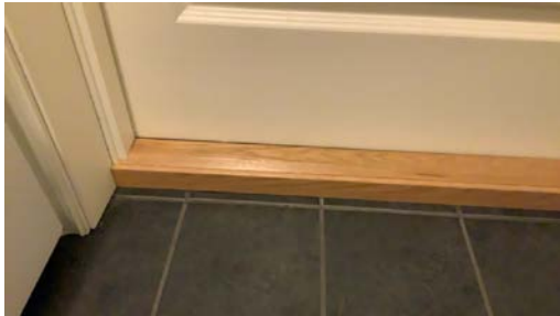
Ingen spalte ved dør
