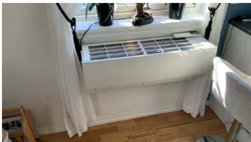
Varmepumpe i stue
