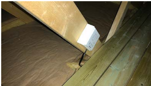
Styring til ventilasjon
