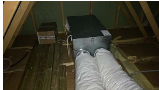
Ventilasjonsanlegg på loft
