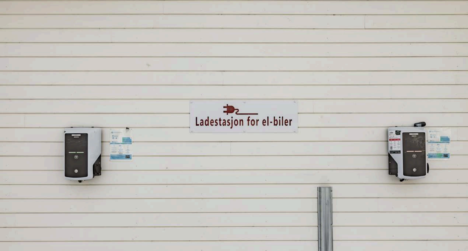
Borettslaget har felles ladestasjon for el-biler.
