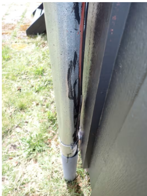
Buling i nedløpsrør.
