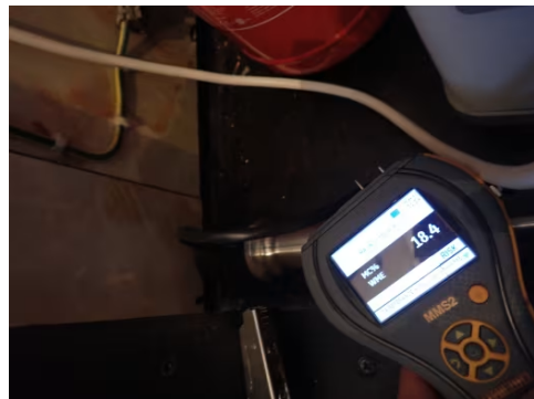
Måling i svill ved bereder.
