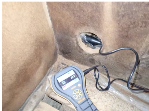
Fuktmåling ved konstruksjon i bod som i dag er fjernet.
