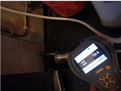
Fuktmåling med hammerelektrode i svill i skap ved bereder. Viser fuktnivå med risiko for utvikling av mugg.
