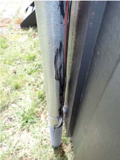
Buling i nedløpsrør.
