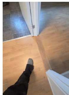
Bilde av punkt i gulvet med ujevnheter og knirk.
