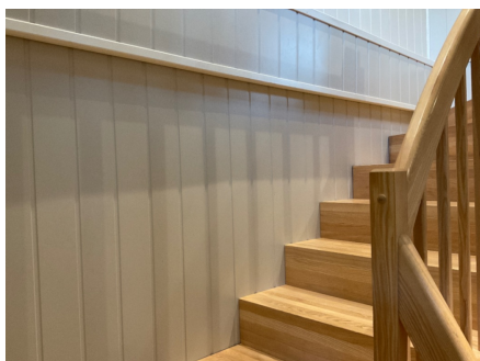
Manglende håndløper på vegg.
