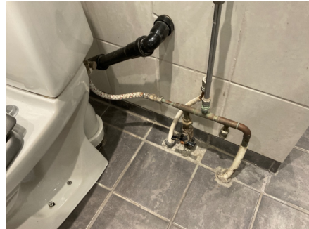
Stoppekran varmtvann. Membran i gulv er ikke ført opp på rørgjennomføringer
