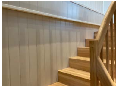
Manglende håndløper på vegg.
