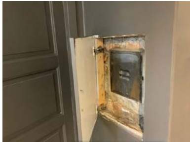
Luke i brennbart materiale plassert foran feieluke.
