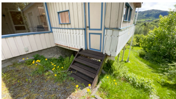
Trapp ved veranda mangler rekkverk
