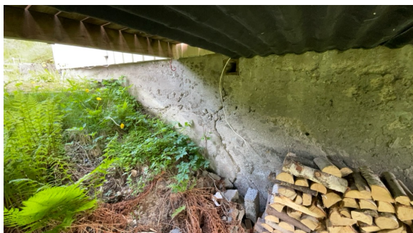
Sprekk i grunnmur på siden mot verandaen.
