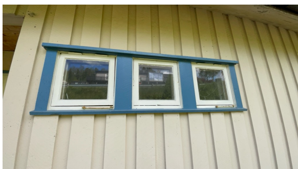
Koblede vinduer i trapperom. Sprekk i en rute utvendig som vil bli skiftet før salg/overtakelse.
