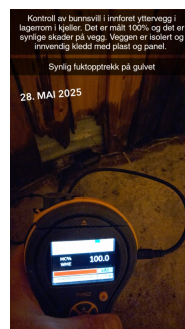
Kontroll av bunnsvill i innforet yttervegg i lagerrom kjeller. Det er målt 100 % og det er synlige skader. Veggene er isolert, innvendig kledd med plast og panel.
