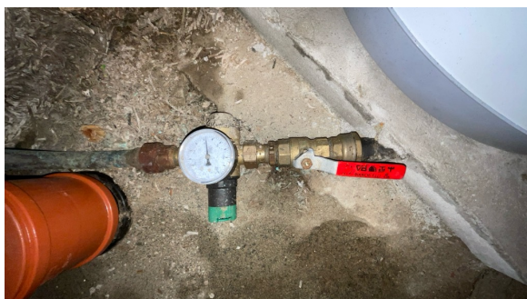
Hovedstoppekrane med reduksjonsventil
