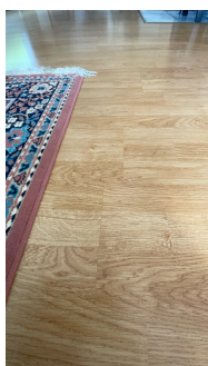
Flytende gulv av laminat er ikke montert i henhold til leggeanvisninger fra produsenten på stue med tanke på forskyvning av skjøter.
