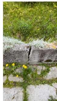
Stor sprekke i støttemur ovenfor boligen
