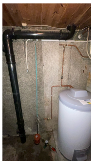
Synlig irr på rør i kjellerbod ved varmtvannsbereder
