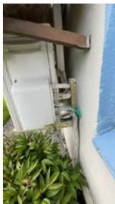
- Isolasjon på utvendige rør er forviftret.
