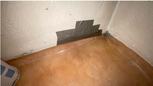
Synlige skader på vegg i dusj
