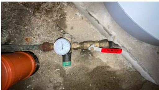
Hovedstoppekrane med reduksjonsventil
