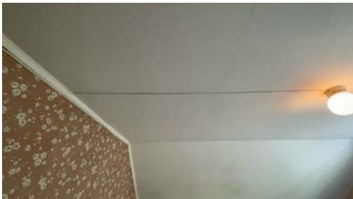
Sprekk i plateskjøt himling på soverom 1 i 2. etasje
