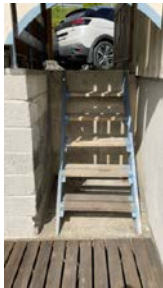
Trapp ved garasje mangler tilstrekkelig sikring/håndløper
