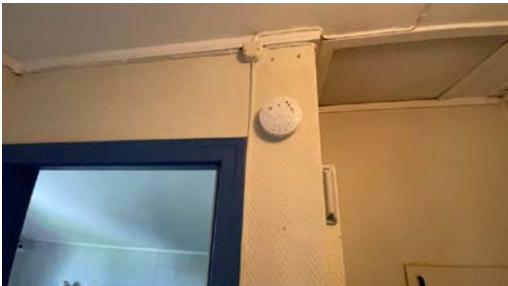
Brannmelder i 2. etasje
