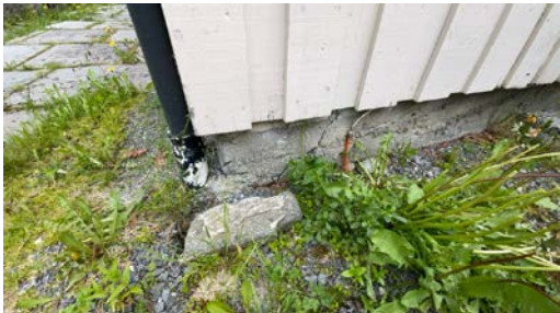
Sprekk i grunnmur mot oversiden
