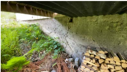
Sprekk i grunnmur på siden mot verandaen.
