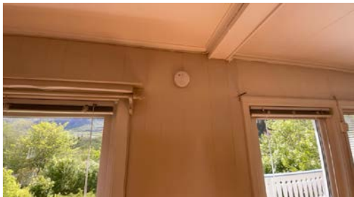
Brannmelder i 1. etasje
