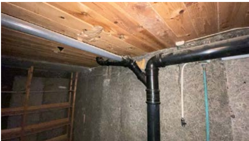
Åpne rør inne i kjellerboden
