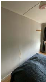
Plateskjøt på soverom 2 i 2. etasje er løs. Gjelder flere skjøter.
