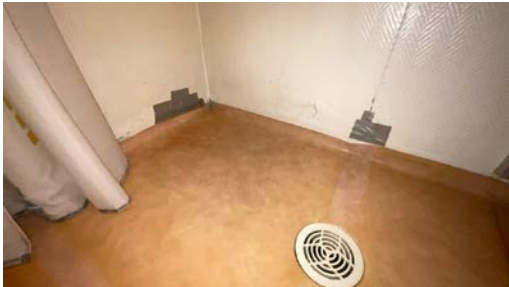
Synlig skade i vegg inne i dusj
