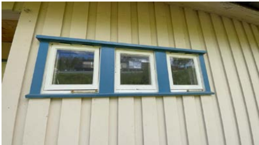
Koblede vinduer i trapperom. Sprekk i en rute utvendig som vil bli skiftet før salg/overtakelse.
