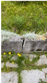
Stor sprekk i støttemur ovenfor boligen
