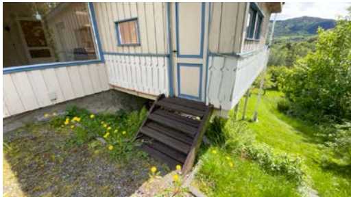
Trapp ved veranda mangler rekkverk
