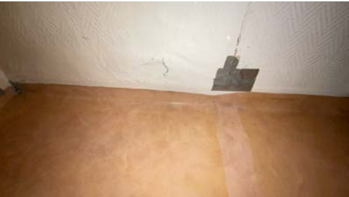
Synlige skader på vegg i dusj
