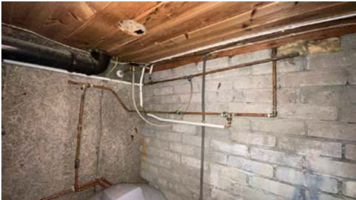
Åpne rør i kjeller
