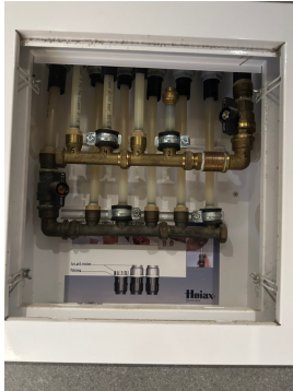
Samleskap med rørkurser og stoppekraner
