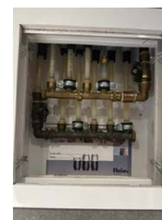
Samleskap med rørkurser og stoppekraner
