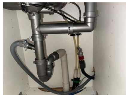
Rørpropplegg i kjøkkenbenk
