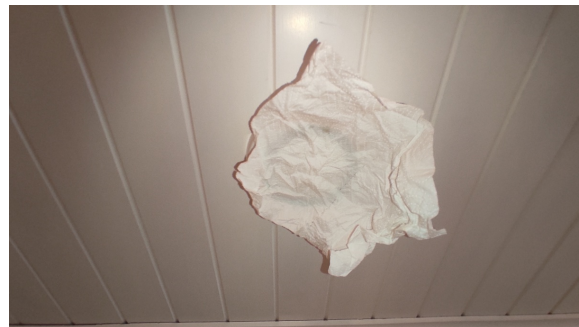
Test av avtrekket.
