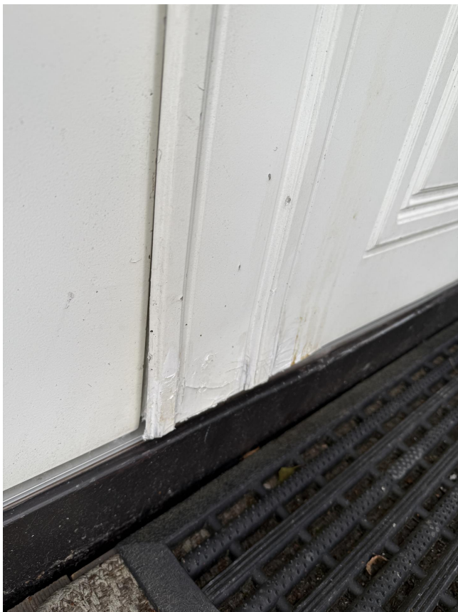
Skade i bunn inngangsdør 1 etasje.
