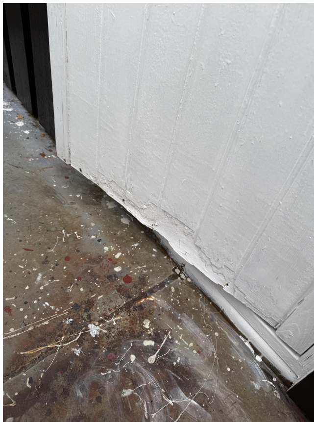
Skade i bunn på balkongdør i loftsetasjen.
