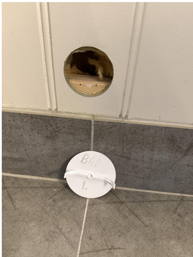
Fukt påvist i bakenforliggende betongvegg. Hulltaking er utført på bad/vakserom i underetasjen.
