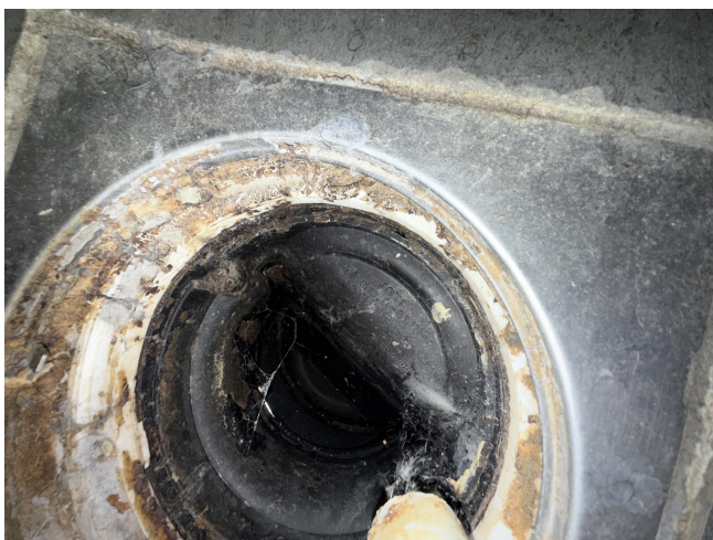
Sluk under dusjkabinett i bad/vaskerom i underetasjen, membran ikke synlig.
