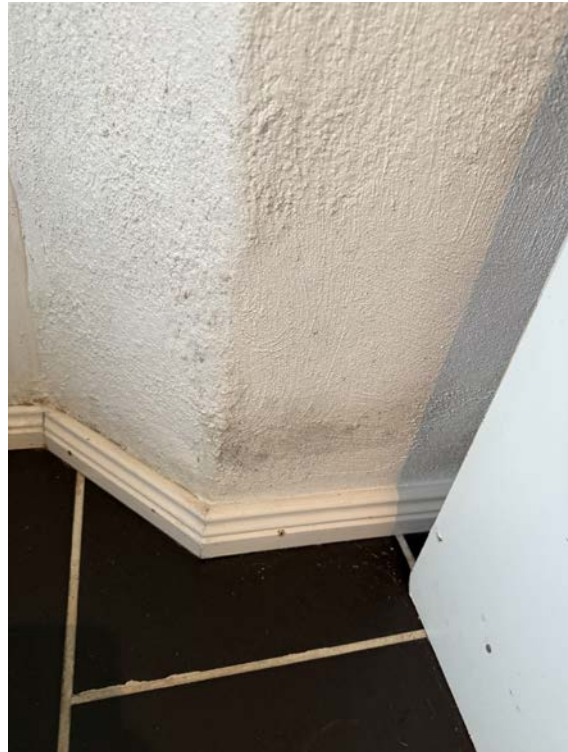
Fuktskjolde ved ytterdør vegg vest, fukt påvist. Tilsvarende observasjoner er gjort enkelte steder på yttervegg.
