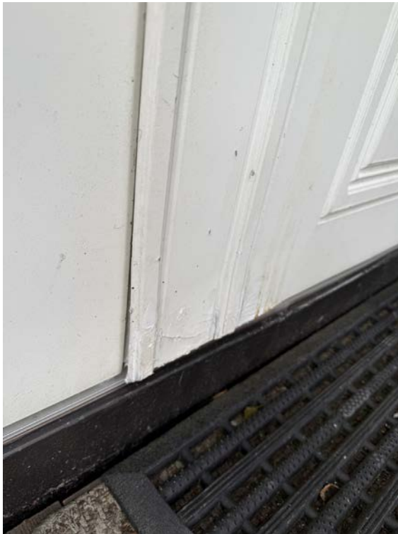
Skade i bunn inngangsdør 1 etasje.
