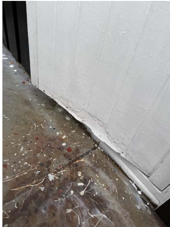
Skade i bunn på balkongdør i loftsetasjen.
