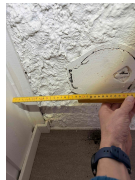
Bildet viser avstand fra sotluke til trevegg.
