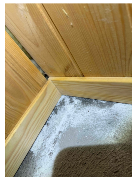
Bildet viser saltutsalg på betonggulv og fuktskjolder på trepanel.
