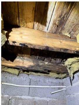
Bildet viser råte i himlingen over carporten.
