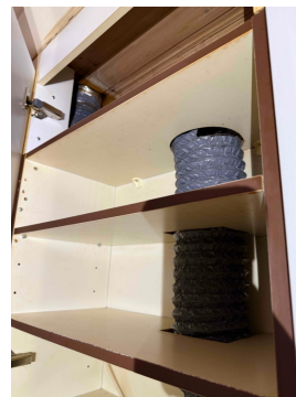
Bildet viser hull i avtrekkskanal.
