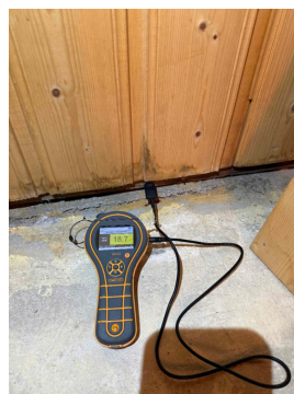
Bilde viser måling i utlekting til trepanel i bod under carporten.
