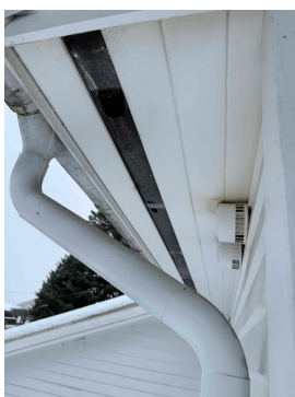
Bildet viser hull i luftnetting i gesims.
