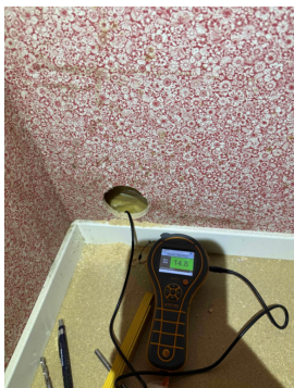
Bildet viser måling i garderobeskap.
