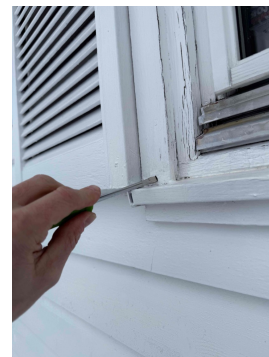
Bildet viser omramming med liten klaring til vannbrett.
