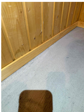
Bildet viser fuktskjolder nederst på trepanel i kjølerom.
