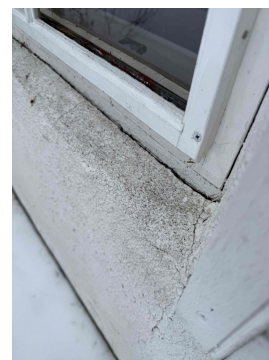
Bildet viser glippe mellom murpuss og vindusramme.
