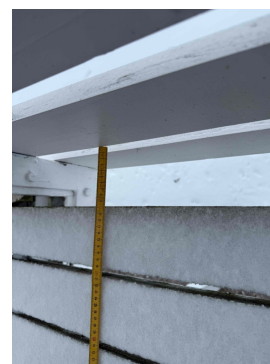
Bildet viser avstan mellom terrassebord og rekkverk på veranda.
