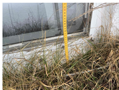
Bilder viser avstand fra kjellervindu til terrenget.
