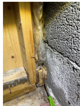
Bildet viser råte i uforet trevegg i kjeller under carport.
