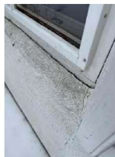
Bildet viser glippe mellom murpuss og vindusramme.
