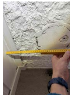
Bildet viser avstand fra sotluke til trevegg.
