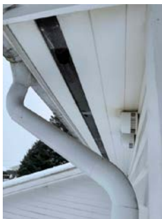
Bildet viser hull i luftnetting i gesims.
