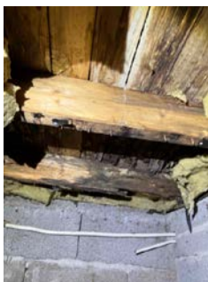
Bildet viser råte i himlingen over carporten.
