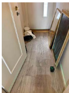
Bildet viser gulv som ikke er fagmessig lagt.
