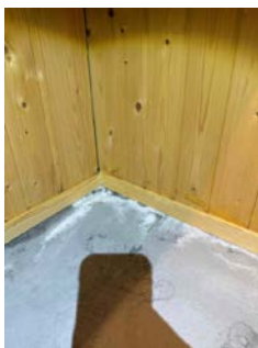
Bildet viser saltutsalg og indikasjon på fukt på boden med vindu.
