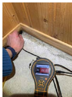
Bildet viser måling på gulvlist i bod med vindu.
