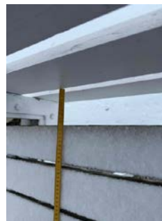
Bildet viser avstan mellom terrassebord og rekkeverk på veranda.
