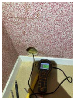
Bildet viser måling i garderobeskap.
