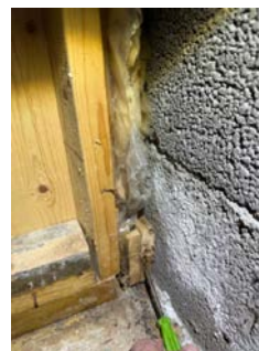
Bildet viser røte i uforet trevegg i kjeller under carport.
