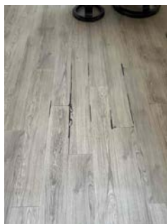
Bildet viser store skader på laminatgulv i stue.
