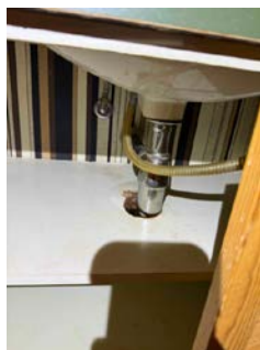
Bildet viser svelling på innredning.
