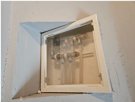
Fordelerskap for vann, montert i felles trappegang.
