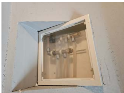
Fordelerskap for vann, montert i felles trappegang.
