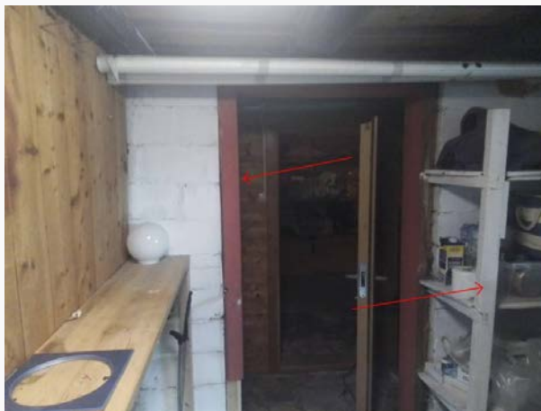
Oversikt mot kjølerom. Stripet borebille i dørstokk og hyllereoler.
