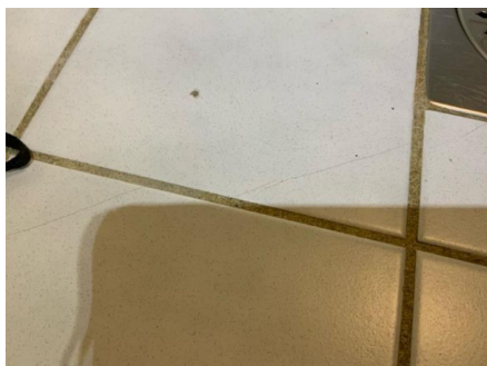
Sprekker i fliser på bad.
