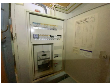
El-skap med automatsikringer.
