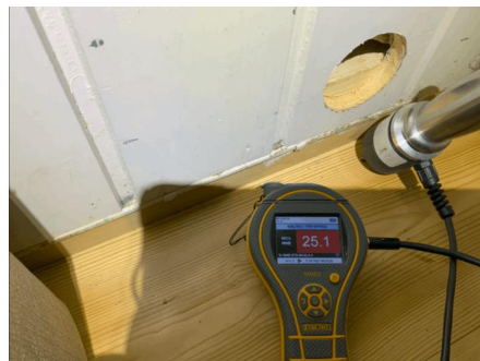
Fuktmåling ble foretatt, jeg målte skadelig fukt i tilfargerulv i kjellerstue
