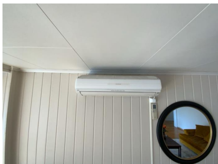
Luft til luft varmepumpe i fra 2012.
