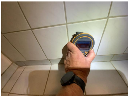
Sprekk og bom på fliser i dusjområde.
