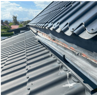
Skade på takrenne mot øst.
