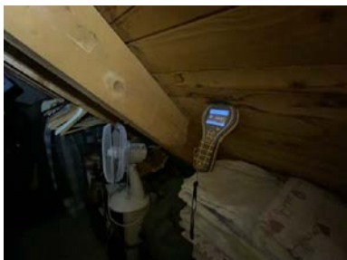
Synlige fuktmerker i tak mot øst, ved enkel fuktmåling registrerte jeg tørre verdier.
