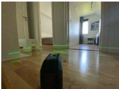
Helningsavvik på 38mm ble målt i gang 2 etg.
