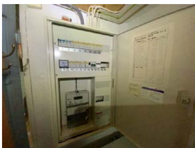
El-skap med automatsikringer.
