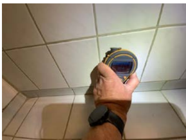
Sprekk og bom på fliser i dusjområde.
