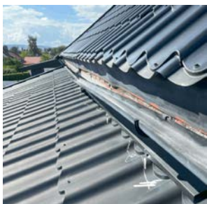
Skade på takrenne mot øst.
