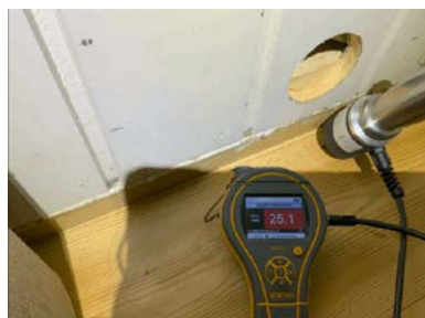
Fuktmåling ble foretatt, jeg målte skadelig fukt i tilfarergulv i kjellerstue
