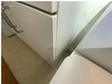
Fuktskader på nedre del av innredning.
