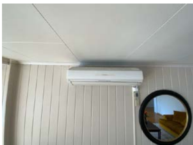
Luft til luft varmpumpe i fra 2012.
