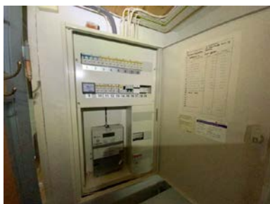
El-skap med automatsikringer.
