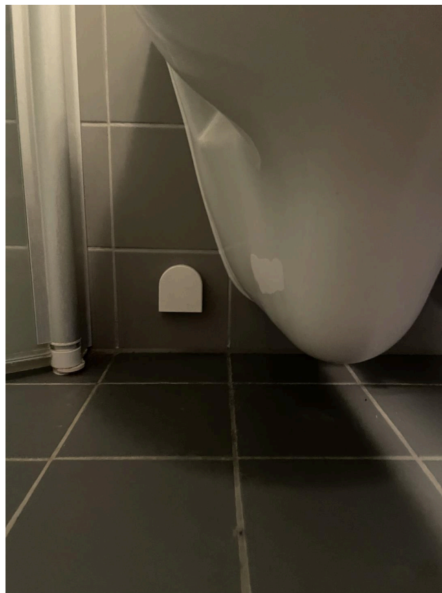
Avrenning fra innebygget sistene , til gulv med flis.
