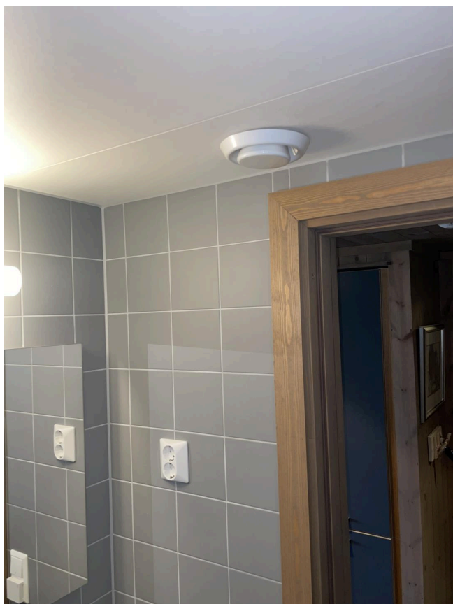
Avtrekks ventil i himling.
