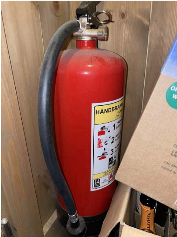
Håndholdt brannslukker er plassert på bod i 3. etasje.
