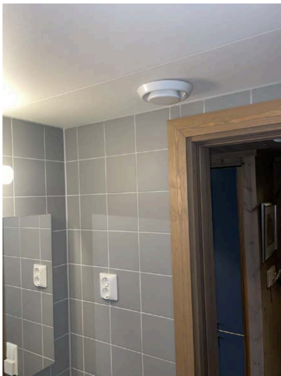
Avtrekks ventil i himling.
