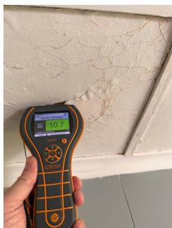
Tørket fuktskjolder i soveroms tak
