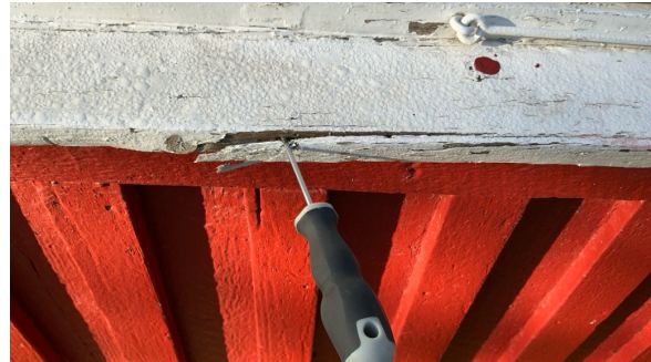
Sprekker i vannbrett
