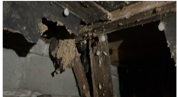
Stubloft har rast ned, råte registrert
