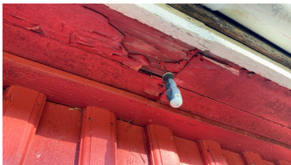
Det er påvist råteskader i bordkledningen.
