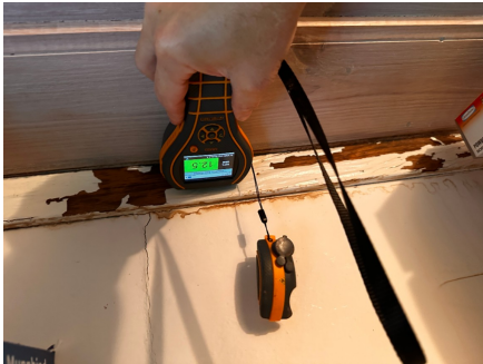
Tørket fuktskjolder i tak på bod
