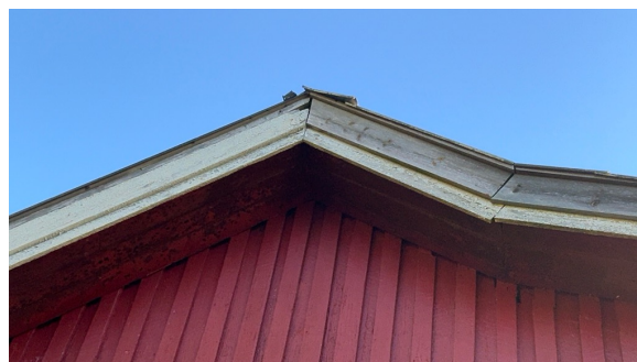
Skade på vindskive
