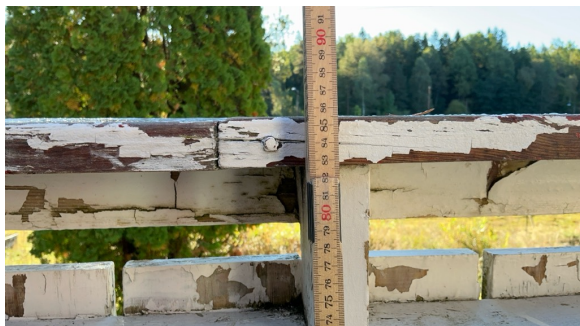
Rekkverk for lavt
