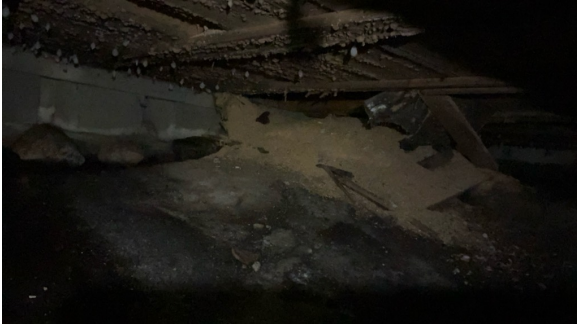
Stubloft har rast ned, råte registrert
