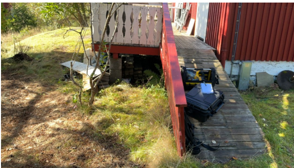
Dagens rekkverk har skjevheter
