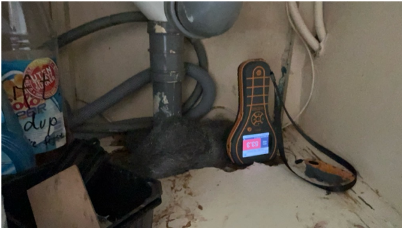
Fuktindikasjoner og råte
