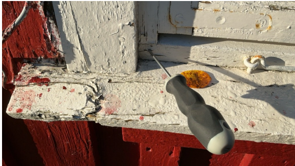
Eksempel på råte
