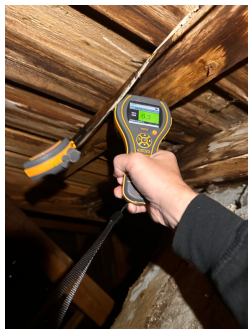
Tørket fuktskjolder i sperrekonstruksjonen.
