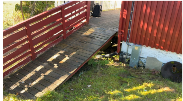
Det er ikke montert rekkverk.
