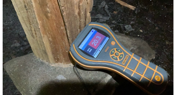
Fuktindikasjon i søyle
