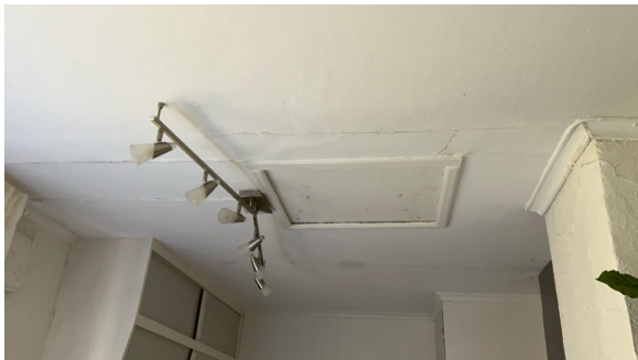
Sprekker i kjøkken tak
