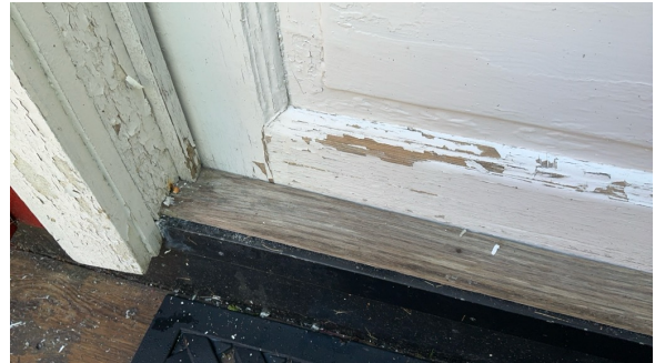
Mulig vann kan renne inn mellom dør og karm.
