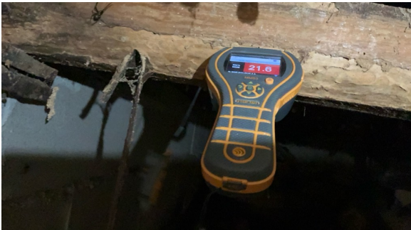
Fuktindikasjon i drager
