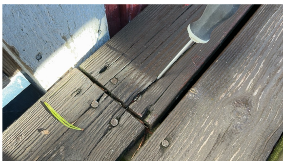
Sprekk i terrassebord
