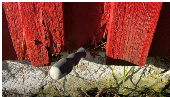
Det er påvist råteskader i veggkonstruksjonen.
