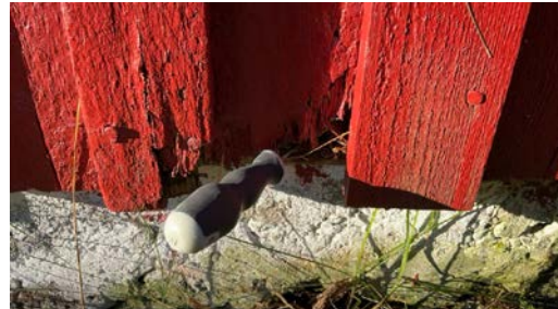
Det er påvist råteskader i veggkonstruksjonen.
