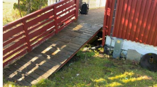
Det er ikke montert rekkverk.
