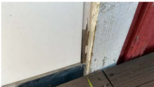
Eksempel på karm i dør som er værslitt
