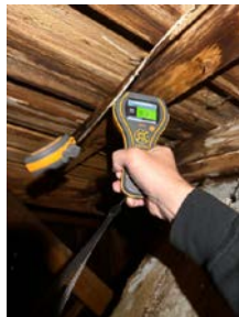
Tørket fuktskjolder i sperrekonstruksjonen.
