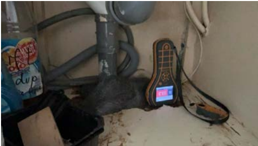
Fuktindikasjoner og råte
