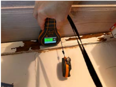
Tørket fuktskjolder i tak på bod
