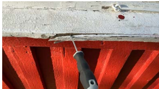
Sprekker i vannbrett
