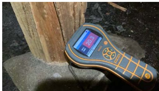
Fuktindikasjon i søyle
