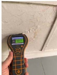
Tørket fuktskjolder i soveroms tak
