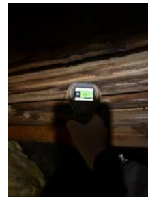
Tørket fuktskjolder i undertak.
