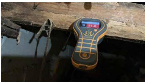
Fuktindikasjon i drager
