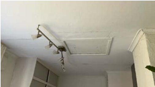
Sprekker i kjøkken tak
