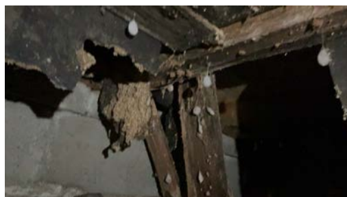
Stubloft har rast ned, råte registrert
