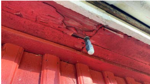
Det er påvist råteskader i bordkledningen.
