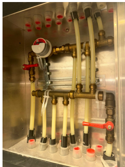
Samleskap med rørkurser og stoppekraner
