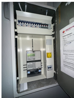
Sikringsskap med automatsikringer.
