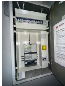
Sikringskap med automatsikringer.
